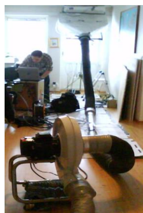
Figure I.1.4 : Mesure sur l'air des performances d'une PAC
