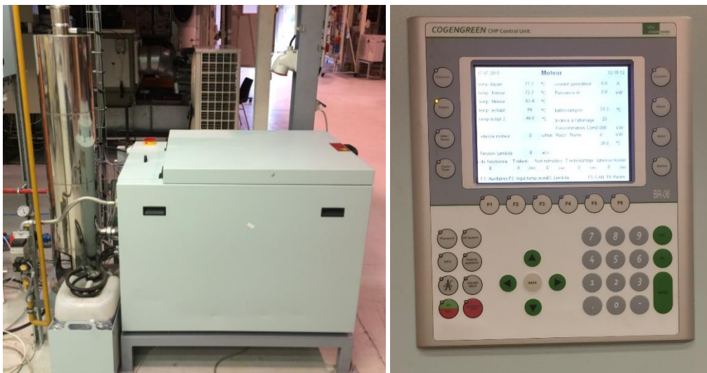
Figure 3.4 : Photo de la micro-cogénération étudiée (gauche) et du boîtier de contrôle (droite)
