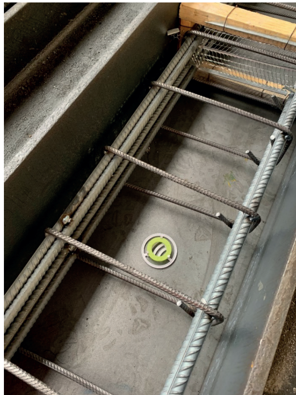
Figure IV. 12 : Puce RFID préparée en fond de coffrage avant le coulage du béton.
