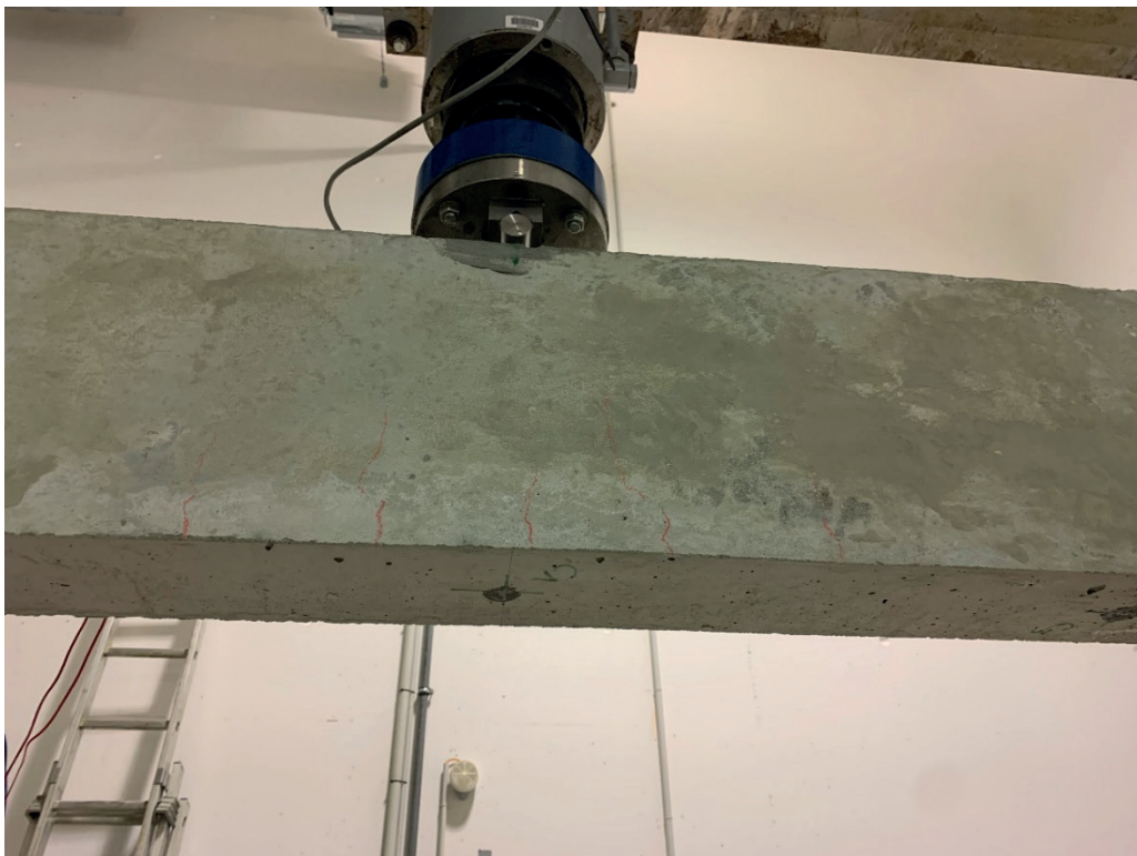
Figure IV. 26 : Repérage des fissures
