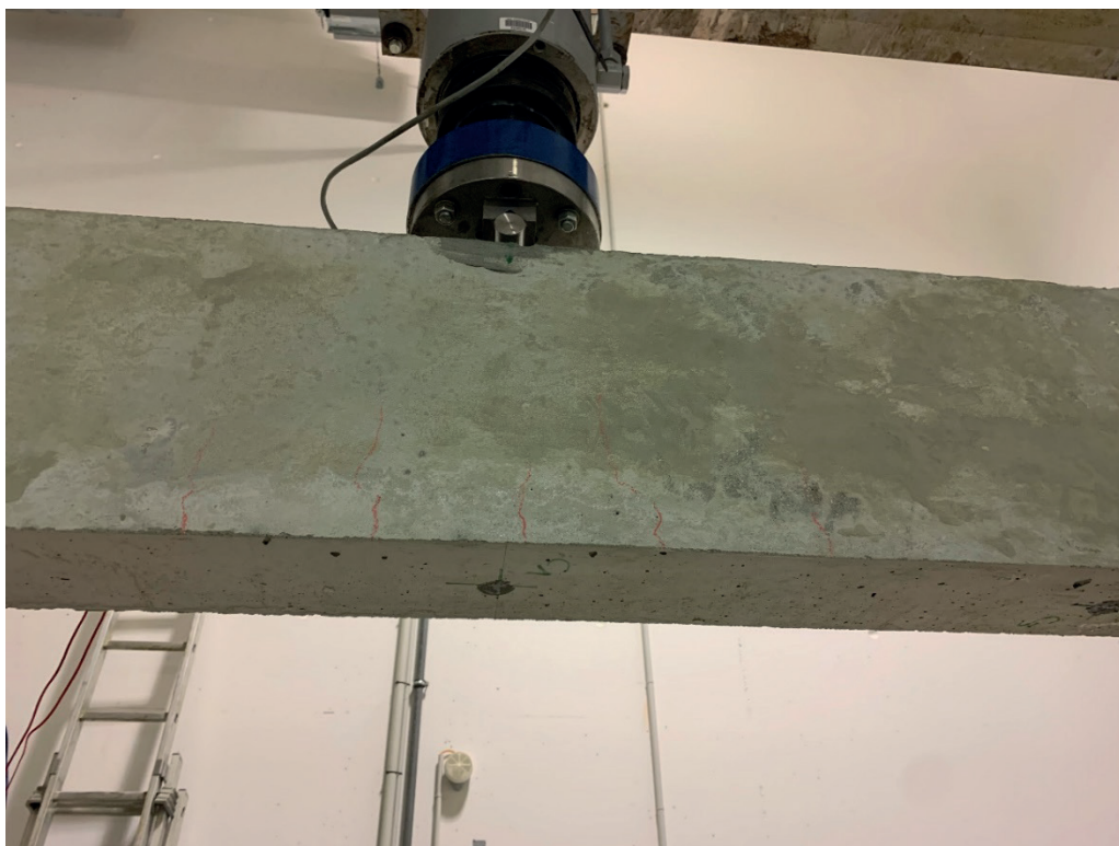
Figure IV. 26 : Repérage des fissures
