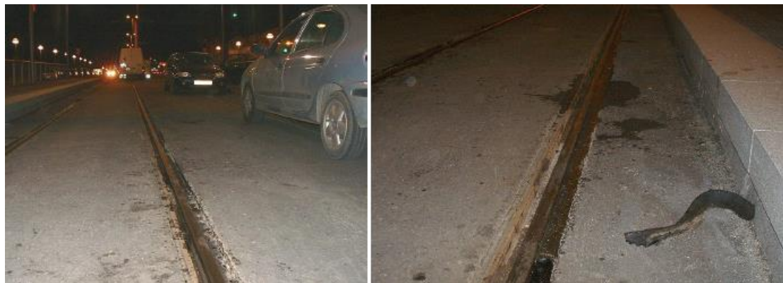
Figure 23 : Cas de ressuage et de départs de matériaux en limite d'interface rail/enrobé (URBAN TRACK, 2010)
