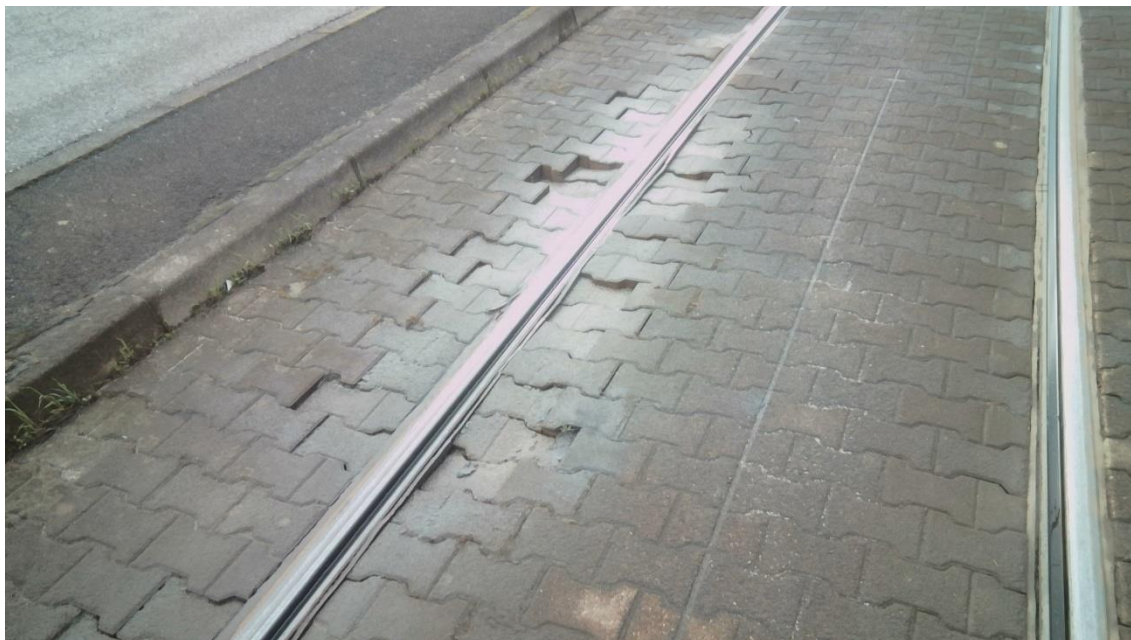
Figure 21 : Affaissement de pavés à Grenoble (Source : ARTELIA, 2019)
