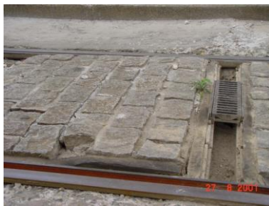
Figure 22 : Cas de désaffleurement provoqué par dilatation du revêtement (URBAN TRACK, 2010) (Tramway T1 – France – Crédit photo RATP)
