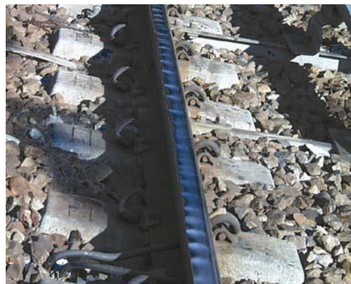
Figure 27 : Usure ondulatoire du rail (Mai, 2011)
