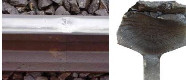
Figure 25 : Cas de fissuration par fatigue en configuration dite « squat » vue de dessus et en coupe (Trollé, 2014)
