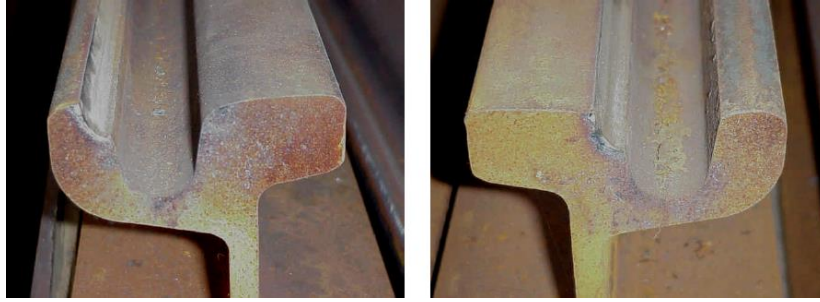
Figure 24 : Cas d'usure abrasive d'un rail à gorge (URBAN TRACK, 2010) (Crédit photo : STIB, Bruxelles)
