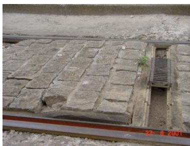
Figure 22 : Cas de désaffleurement provoqué par dilatation du revêtement (URBAN TRACK, 2010) (Tramway T1 – France – Crédit photo RATP)
