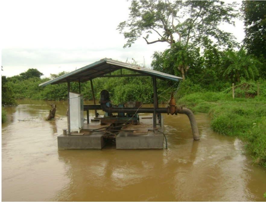
Photo 39 : Station de pompage sur la Nam Nyam (À ban Nongphong-Neua, juillet 2009)
