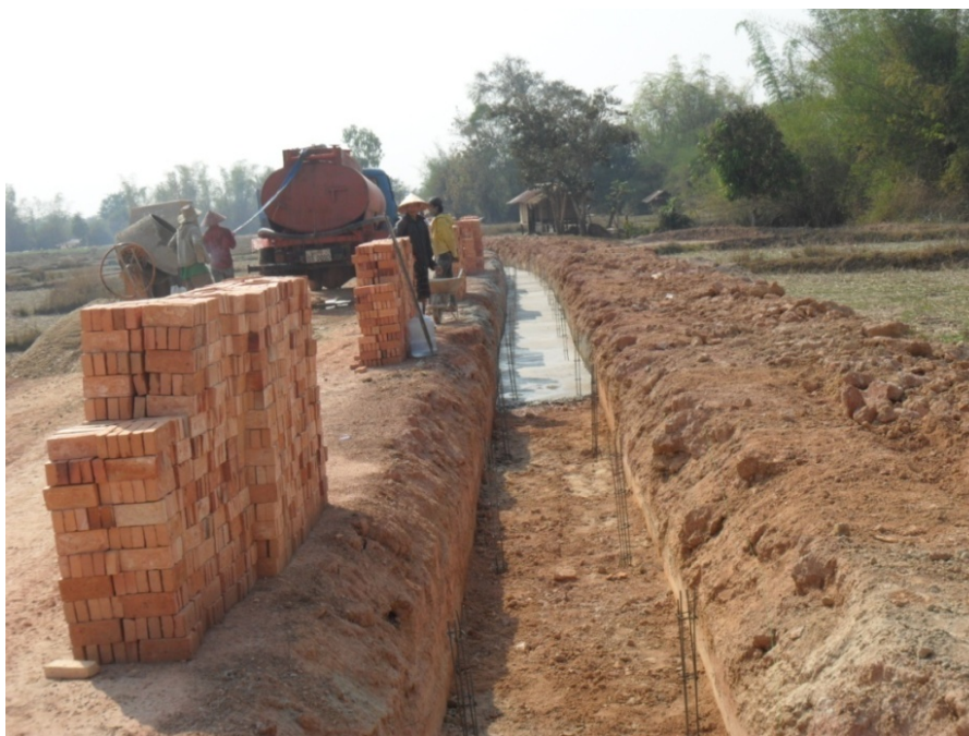
Photo 44 : La construction du réseau de canaux d'irrigation en béton (À ban Phathao , février 2011)
