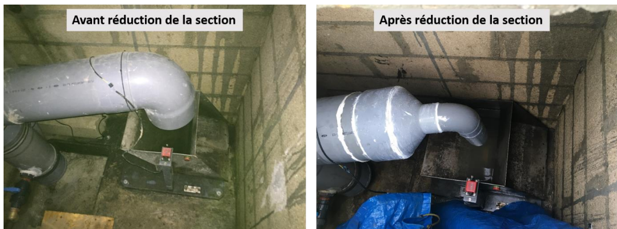
Figure 2.18. Le tuyau versant dans l'auget basculant des eaux brutes, avant et après réduction de sa section.
