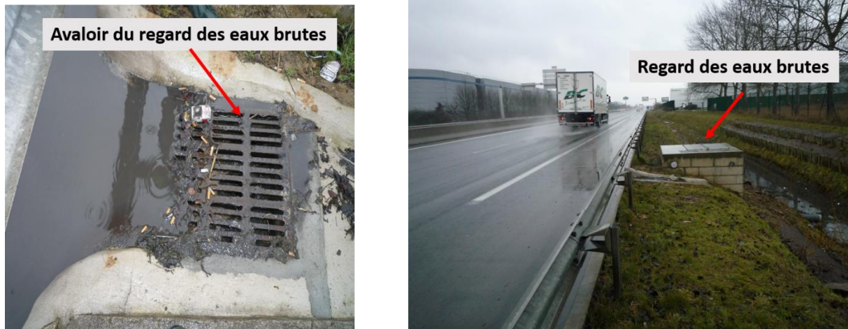
Figure 2.17. Regard des eaux brutes et son avaloir.
