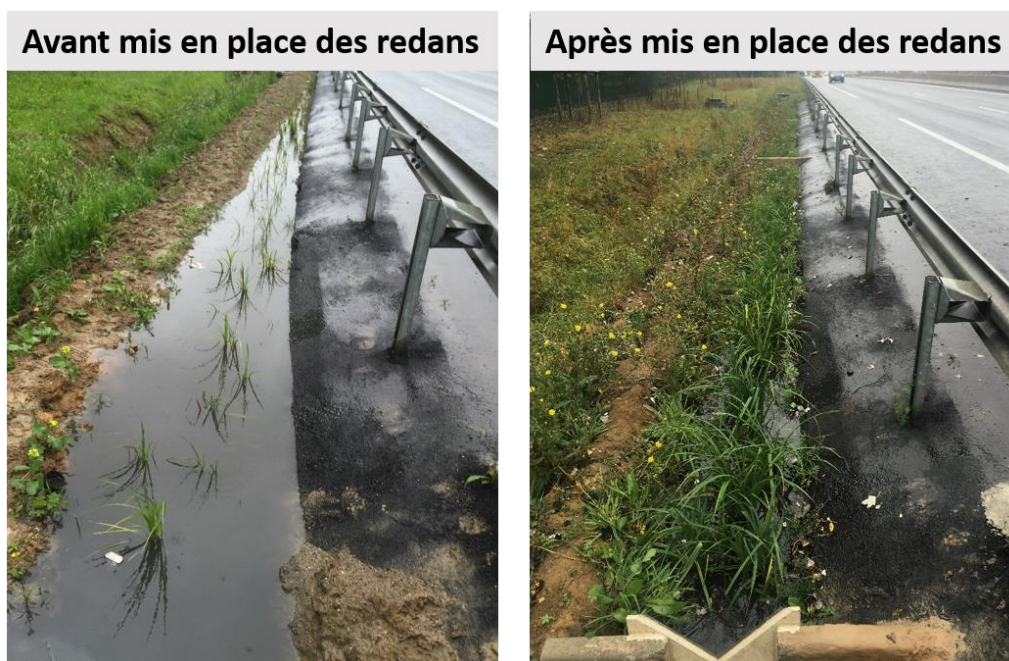
Figure 2.11. Photos montrant la noue avant et après la mise en place des redans
