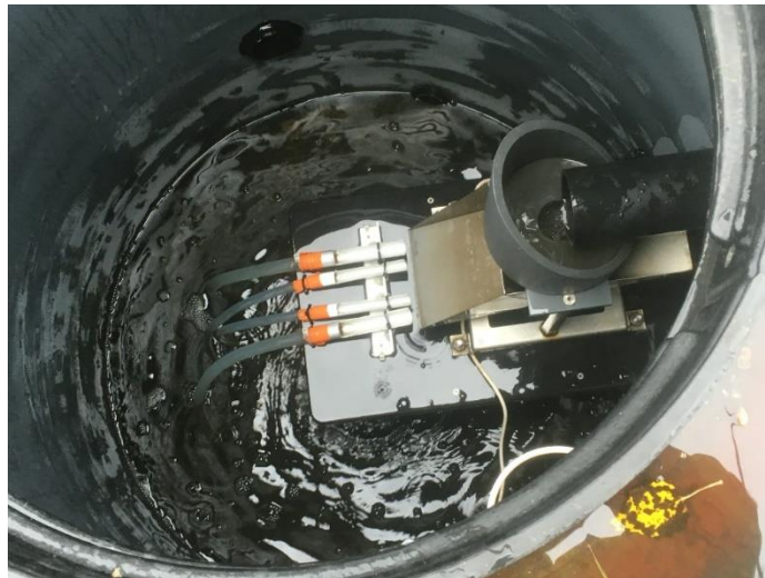
Figure 2.19. Auget basculant mesurant le débit drainé de la noue filtrante.
