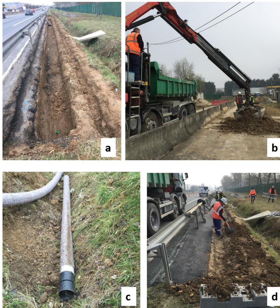
Figure 2.10. Etapes de la construction de la noue filtrante (a) excavation du sol natif ; (b) mélange du massif filtrant ; (c) drain mis au fond de la noue ; (d) remplissage de la noue par le massif filtrant.
