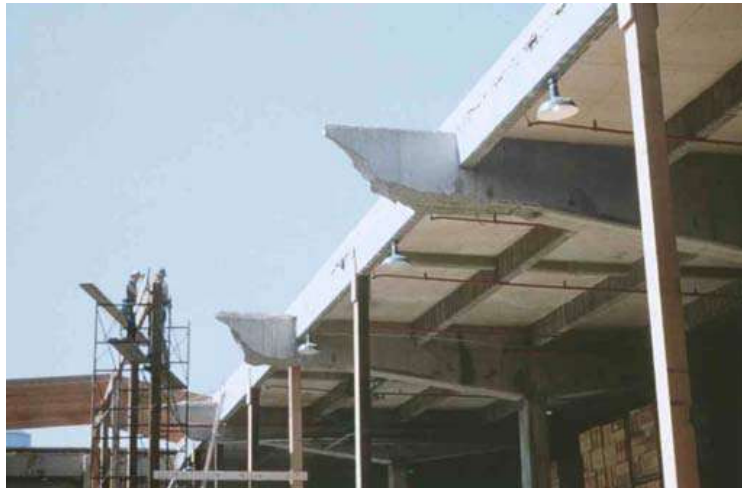
FIGURE 1.1 – Rupture des poutres de l'entrepôt AMC du Wilkins Air Force (États-Unis, 1955) (Collins et al. , 2008)
