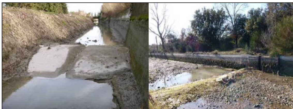
Figure 127 : Dispositifs pour réhausser la ligne d'eau du canal et mieux alimenter certaines prises. Source : BRL, 2014.
