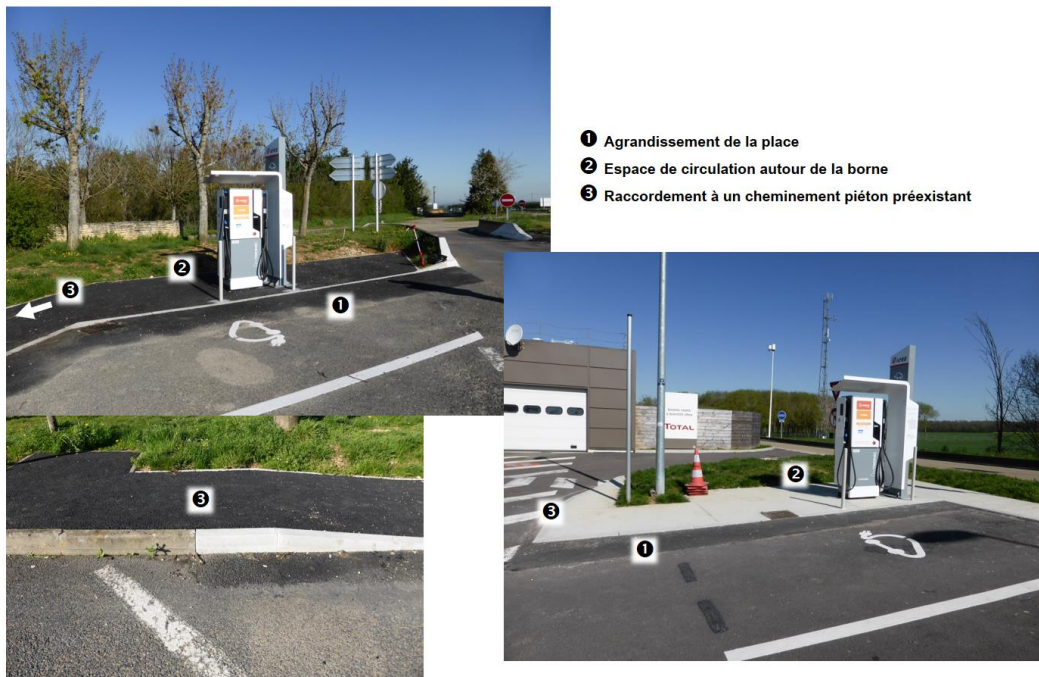
FIGURE 5-5 DEUX EXEMPLES DE STATIONS DE RECHARGE AUTOROUTIERES
