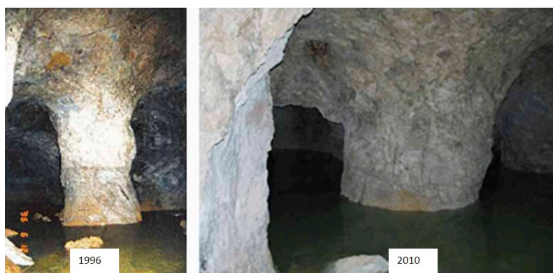
Figure 5.5 – Vues d'un même pilier dans la carrière abandonnée de Roquevaire (Bouches-du-Rhône- 13) avec deux niveaux d'ennoyage différent (en 1996 et en 2010) ©Ineris
