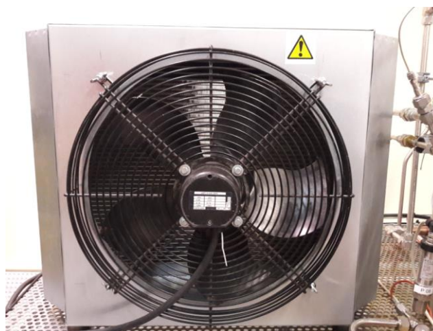
Figure 102 : Vue du ventilateur sur le condenseur
