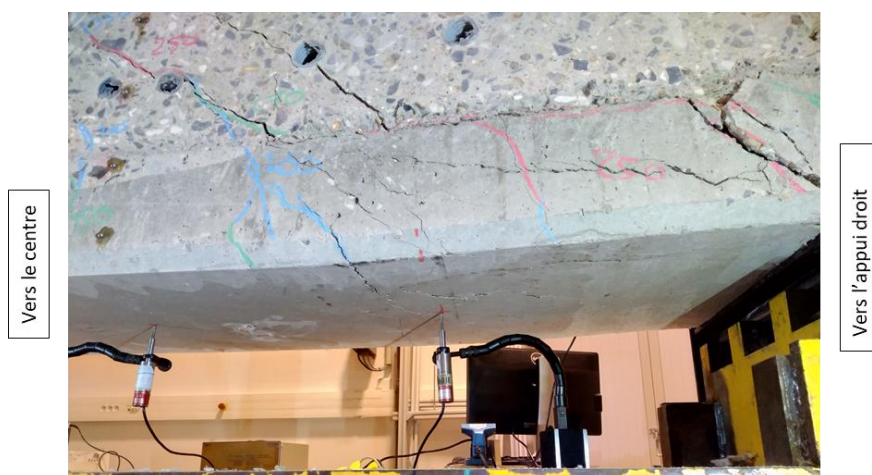
Figure 140 : Extrait représentatif de la fissuration proche de la ruine pour la poutre PuP1 (vert (sous le bleu) : 150 kN, bleu : 200 kN, rouge : 250 kN, vert (sur le bleu) : 270 kN)
