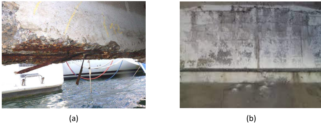
Figure 14 : Corrosion des aciers en milieu marin à gauche (images CEBTP https://www.experts-cebtpti.org ) et réaction d'alcali-granulat dans un sommier de pont à droite (Mommer et al., 2004).
