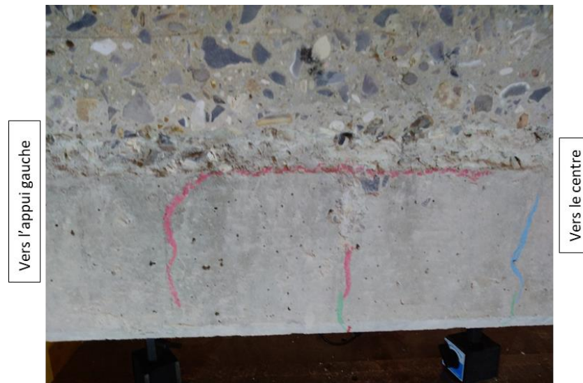
Figure 139 : Extrait représentatif de la fissuration pour la poutre PuP2 (vert : 200 kN, bleu : 250 kN ; rouge : 270 kN)
