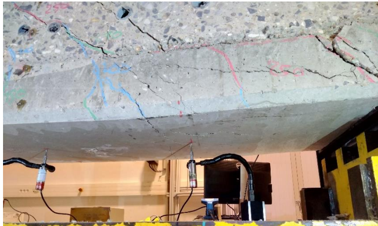
Figure 131 : Repérage de fissures de la poutre PuP1
