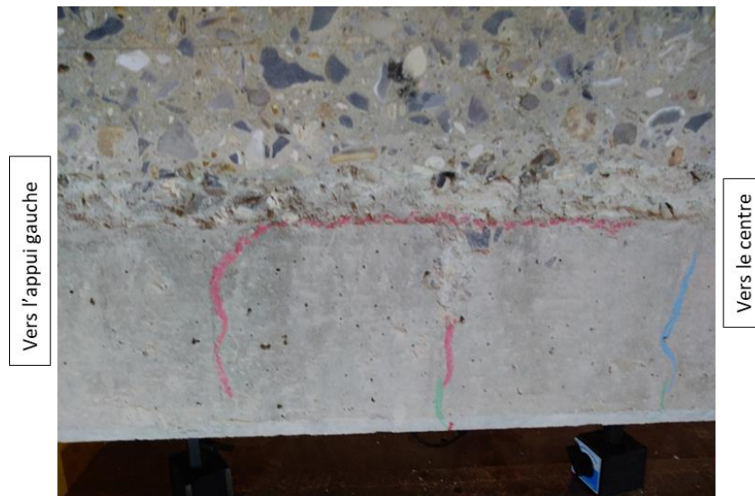
Figure 139 : Extrait représentatif de la fissuration pour la poutre PuP2 (vert : 200 kN, bleu : 250 kN ; rouge : 270 kN)
