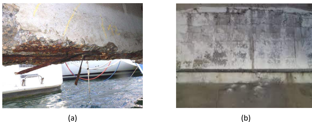
Figure 14 : Corrosion des aciers en milieu marin à gauche (images CEBTP https://www.experts-cebtpti.org ) et réaction d'alcali-granulat dans un sommier de pont à droite (Mommer et al., 2004).
