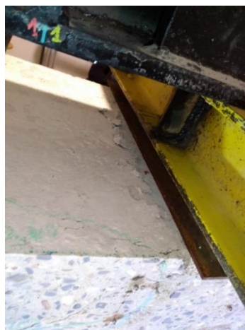
Figure 143 : Détail de la rupture sur la fibre supérieure ( PuP2 )
