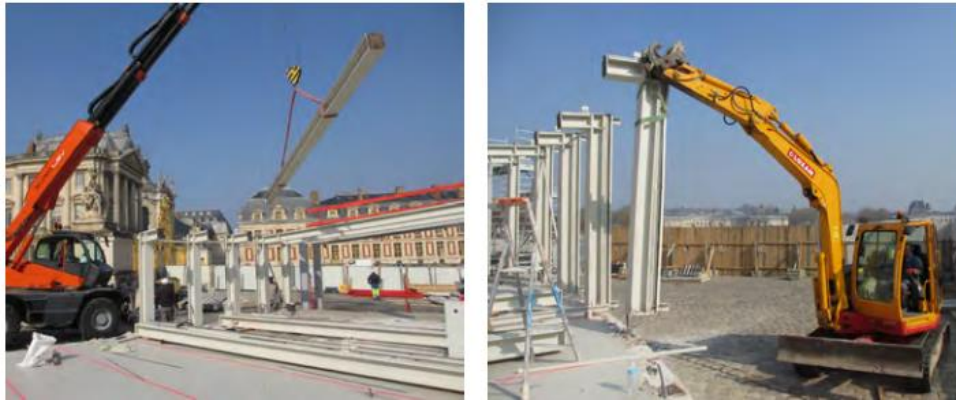
Figure 81 : Dépose par déboulonnage et élingage de la structure métallique du pavillon provisoire à Versailles (Benoit et al., 2018)
