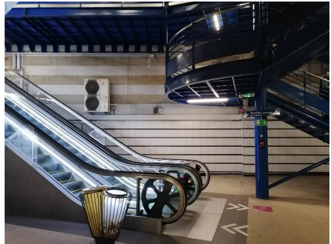
Figure 32 : escalier mécanique en gare de La Défense
