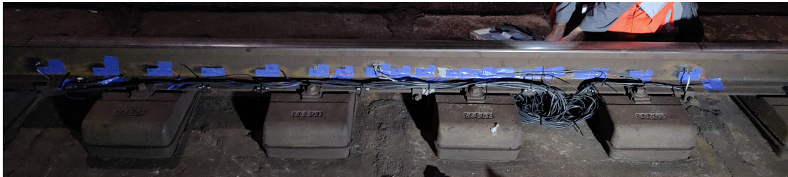
FIGURE 3.6. – Photographie du système installé.
