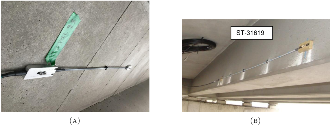
FIGURE 4.2 – cordes optiques fixées sur le pont suivies par OSMOS (Source : OSMOS).
