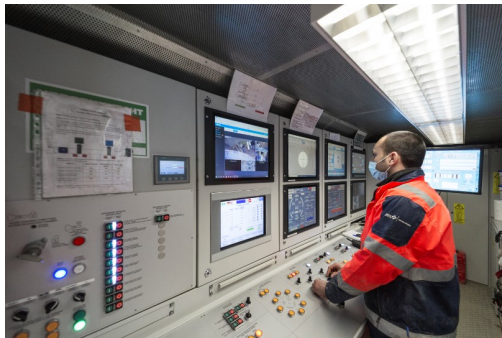
(e) Cabine de pilotage du tunnelier
