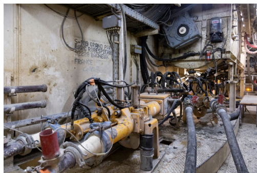
(p) Pompe de mortier à l'intérieur du tunnelier
