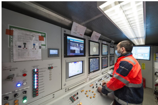
(e) Cabine de pilotage du tunnelier
