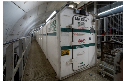
(f) Chambre de survie en cas d'accident
