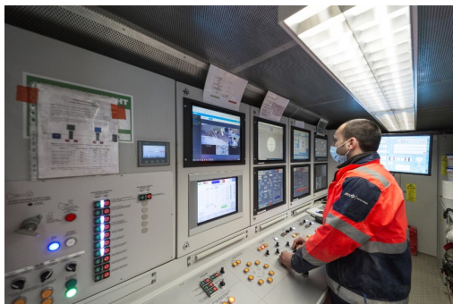
(e) Cabine de pilotage du tunnelier
