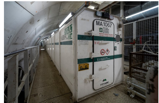
(f) Chambre de survie en cas d'accident
