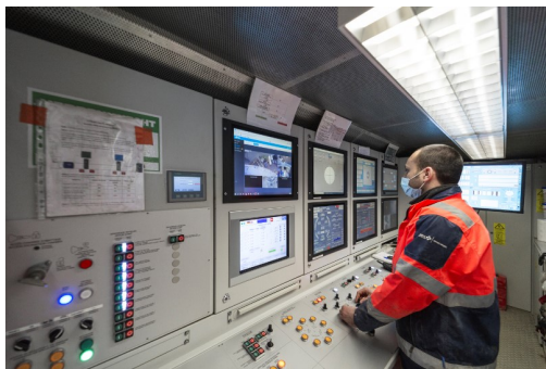
(e) Cabine de pilotage du tunnelier
