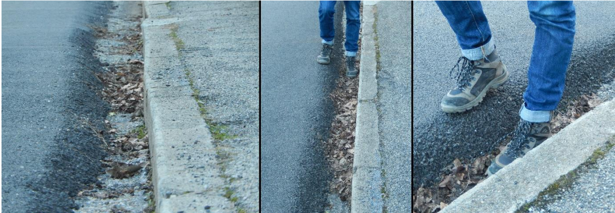
Figure 13. Un caniveau neuf mais difficilement maintenable. Ces images ont été prises à la fin de la journée pendant laquelle j'avais observé la tournée de balayage : trop étroit et profond (en témoigne la paire de pieds complices venue donner l'échelle), le caniveau n'avait pu être convenablement débarrassé des feuilles mortes qui l'encombraient.
