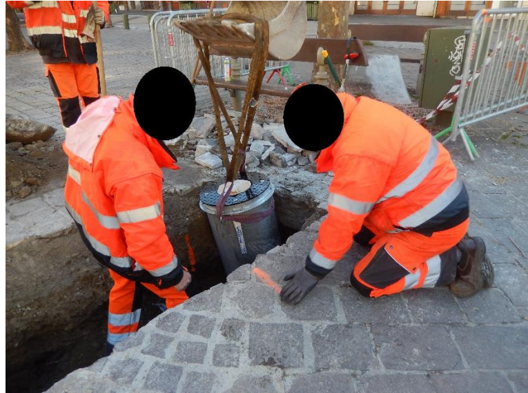
Figure 17. Plus tard dans la matinée, une première tentative de mise en place. Les repères tracés à la bombe orange sur le sol et sur la paroi de la tranchée indiquent l'emplacement souhaité pour la borne.
