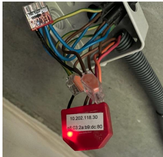
Figure 25: Capteur Shelly1PM installé au niveau du boîtier d'éclairage
