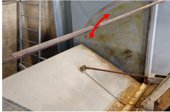
FIGURE 1.6 – Pelle permettant de régler la hauteur d'eau dans le canal 1. La flèche rouge désigne la rotation possible de la pelle.
